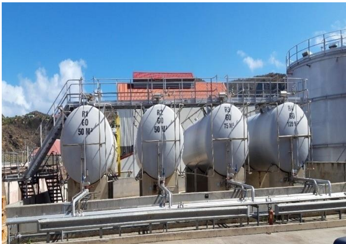
4 réservoirs horizontaux de gasoil
