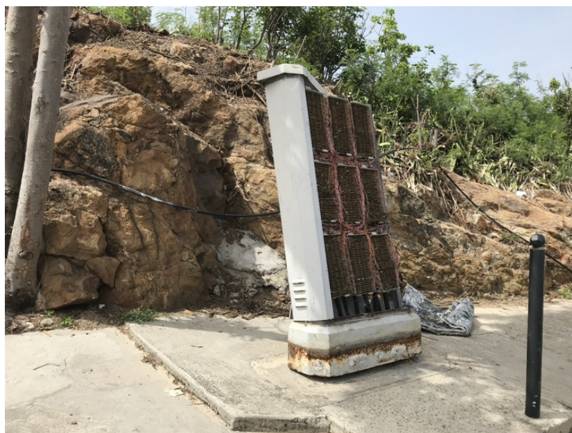
Figure 17 : Dégâts d'IRMA sur les infrastructures télécoms
