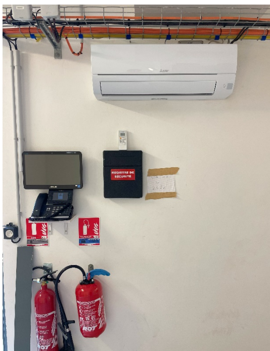
Figure 38 : Dispositif incendie et climatisation
