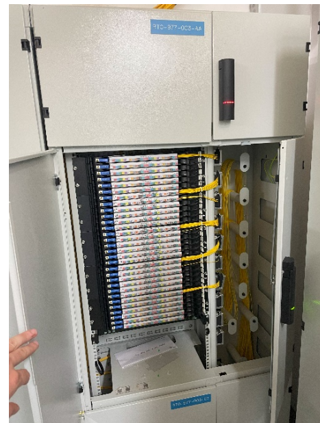
Figure 34 : Répartiteur de transport optique - RTO
