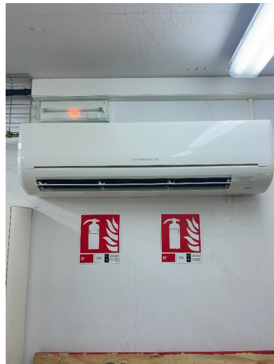
Figure 21 : Climatisation non fonctionnelle
