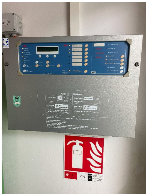
Figure 23 : Système incendie non fonctionnel
