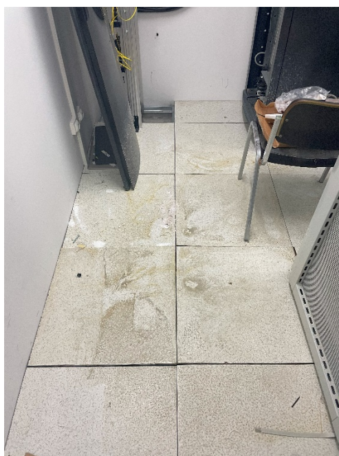
Figure 29 : Traces d'infiltration d'eau
