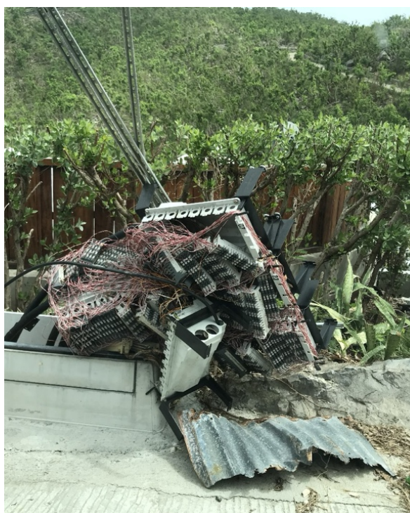
Figure 19 : Dégâts d'IRMA sur les infrastructures télécoms
