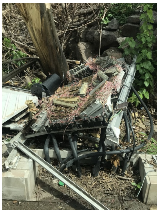
Figure 18 : Dégâts d'IRMA sur les infrastructures télécoms
