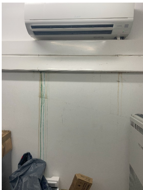
Figure 27 : Traces d'infiltration d'eau
